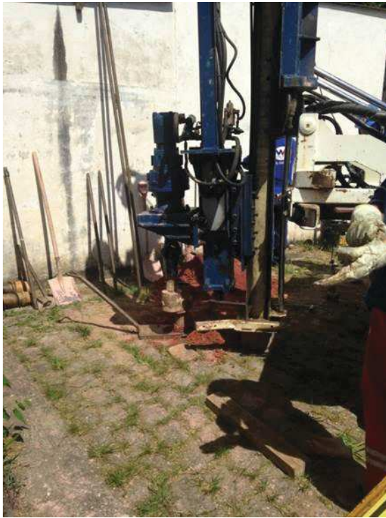
Fig 1: Sondagem mecanizada para coleta de amostra de solo e futura instalação de poços de monitoramento
